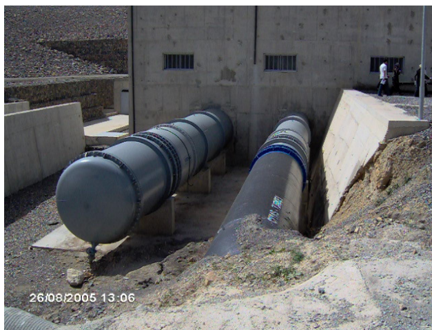
Photo 3. Conduites d'AEP et d'irrigation à la sortie du réservoir de O. Athménia (photo A. Mebarki, 2008)
